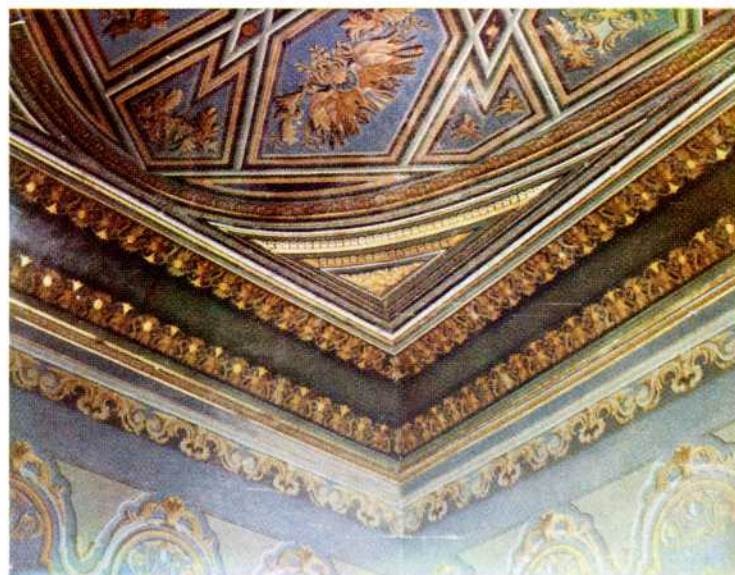
جانب من الزخارف الجدارية قبل الترميم .
