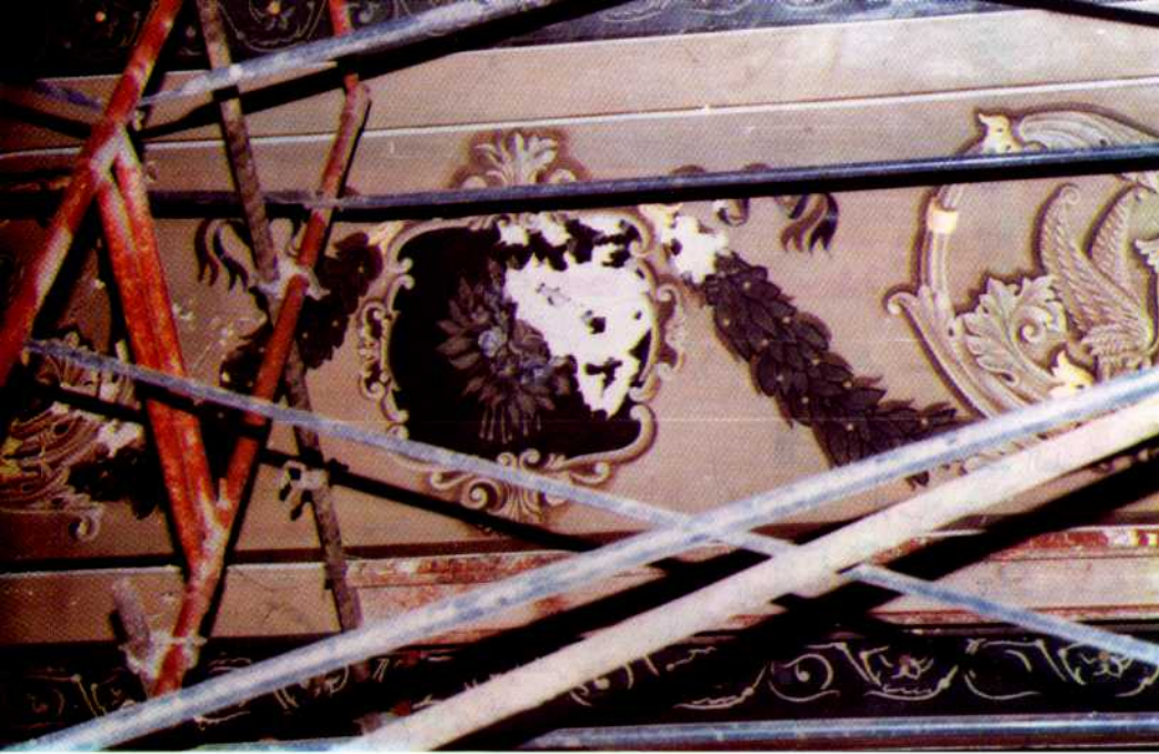
أحد النقوش الجدارية قبل الترميم .
