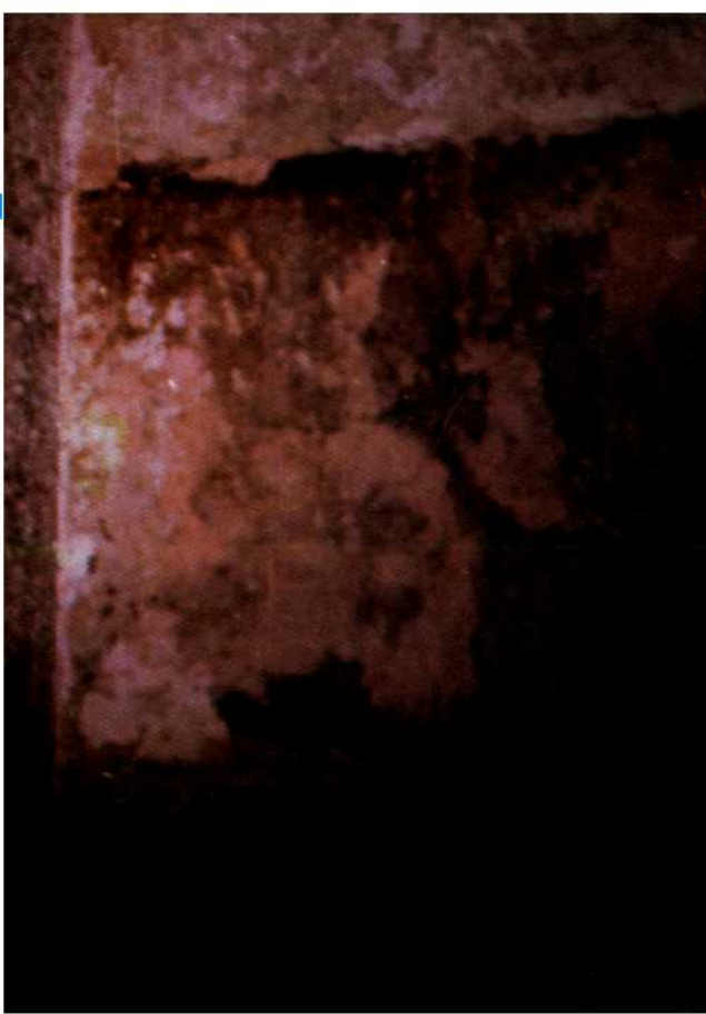
١١ - طبقة البلاستر على جدران أحد الممرات قبل أعمال الترميم .
