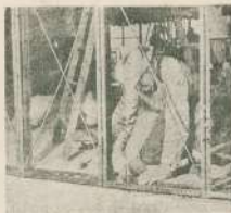
وتعمل تركيبات الأعمال الصحية والكهربائية داخل القواطع وأخيراً تبييت ألواح السقف والمواطع الناطقة
