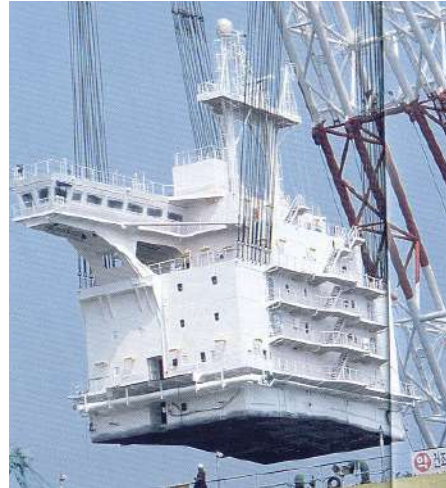
شكل(٢٥): تنفيذ المنشأة العلوية قد يتم بشكل منفصل بل وفي مكان منفصل
