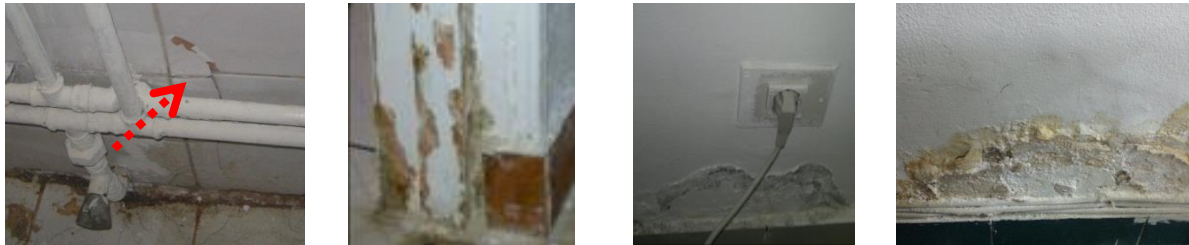
تضرر أعمال المحارة والدهانات قد تضرر بالأعمال الكهربائية إتلاف أعمال النجارة انتفاش الأرضيات والحوائط شكل (٦): تأثير مشاكل الأعمال الصحية على مواد وعناصر النهو داخل المباني (الدراسة الميدانية، الباحث)
