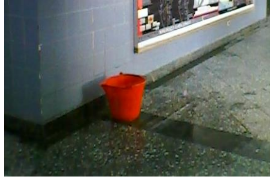
تسرب مياه ناتج عن عزل سيء لفواصل تمدد بأسطح أحد المباني
