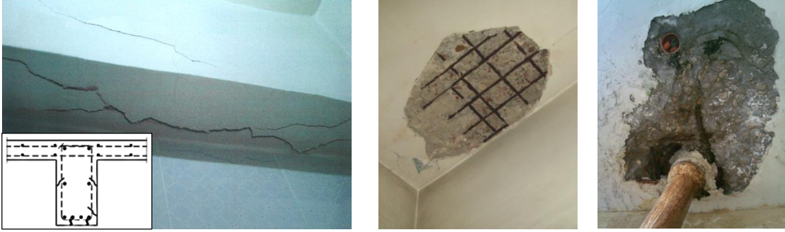
شكل (٧): تؤدي المياه المتسربة إلى صدأ حديد التسليح وتلف الغطاء الخرساني لحديد التسليح (الدراسة الميدانية، الباحث)
