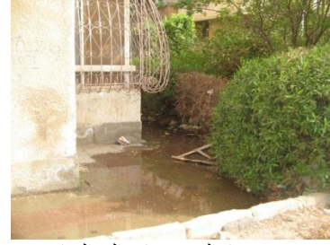
تسرب مياه المزروعات إلى المباني
