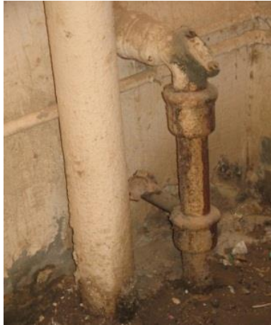
صدأ وتآكل المواسير الزهر بسبب تعرضها للمياه من الخارج وفي غياب الصيانة
