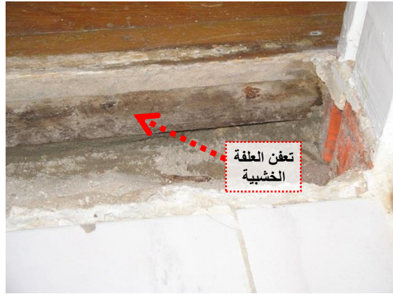
فواصل بين أرضية حمام وأحد الغرف تظهر به آثار الرطوبة وتسرب المياه على العلفه الخشبية لأرضية الغرفة شكل (٣٠): التنفيذ السليء لعزل حواجز الأبواب بين أرضية الحمام والغرف المحيطة (الدراسة الميدانية، الباحث)
