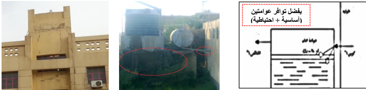
شكل (١٢): مشاكل ناتجة عن تلف عوامات الخزانات العلوية وفي غياب العزل الصحيح لأسطح المباني (الدراسة الميدانية، الباحث)
