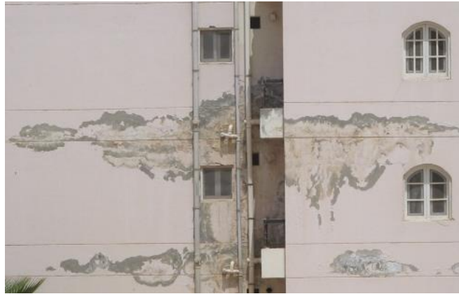
نشع بطول واجهة الدور بالكامل نتيجة تسرب المياه عبر هذه الفواصل من أرضية الحمام إلى أرضية الغرف المختلفة
