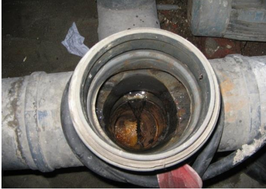
تآكل الأكوام بسبب المنظفات الكيميائية لأحد المغاسل التجارية شكل (٢٦): تآكل مواسير الصرف بسبب القوارض والمواد الكيميائية (الدراسة الميدانية، الباحث)
