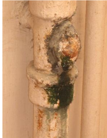
تسريب نتيجة استخدام أسمنت بدلا من استخدام جوانات وإحكام ربط الوصلات لطبة تسليك
