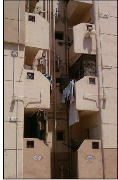
شكل (٤-٢٢): نماذج العمارات التي تعاني من مشاكل المياه والصرف بمنطقة زينهم.
