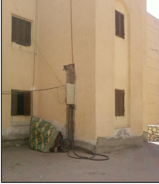
شكل (٤-٣٠): استخدام الكابلات لإنارة الشوارع بمنطقة زينهم.
