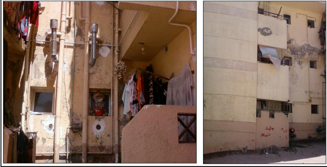
شكل (٤-٦): نموذج لبعض المباني المتضررة من شبكات المياه والصرف بمنطقة زينهم.
