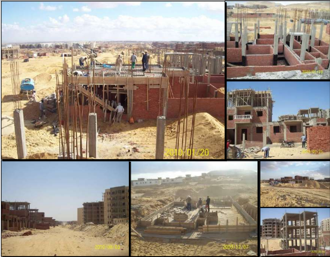
شكل (٢-٣٢) صور توضح عدم توافر المرافق وكذلك تفرغ الشباب للإشراف علي المقاول (بواسطة الباحث، ٢٠١٠م)
