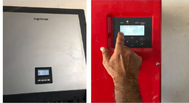
شكل (٢-٢٧) المحول الذي يقوم بتحويل التيار المستمر الى تيار متردد المصدر: تصوير الباحث في ١٧-١٠-٢٠٢٢
