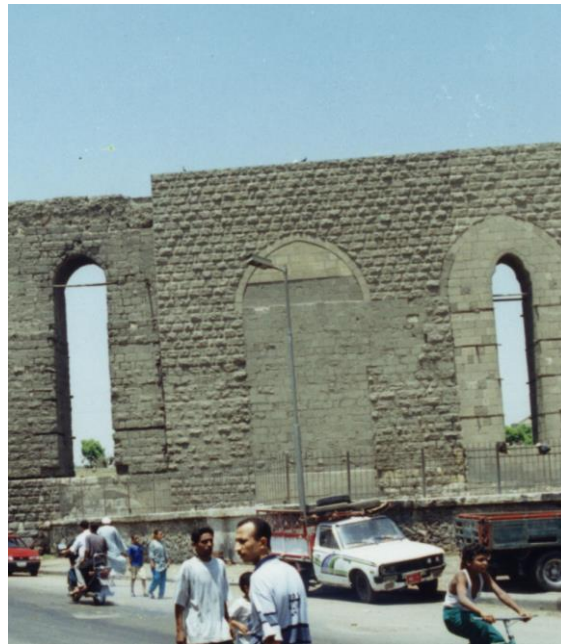
أحد عقود مجراه مياه القناطر التي سدت. شكل رقم (50)
