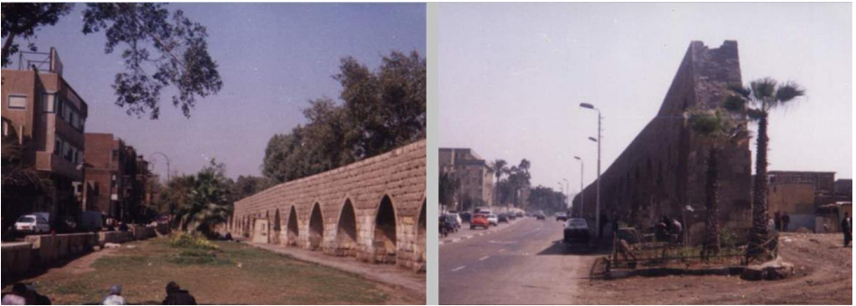
آثار نشع المياه علي القناطر نتيجة زراعة النباتات دون إختيار مدقق لموقعها أو أسلوب الري المناسب لها. شكل رقم (113)
