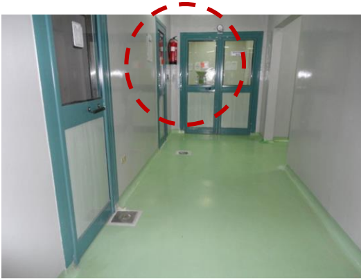
شكل (م-٢٧) . طفايات الحريق المثبتة على حائط الممر الداخلي بمنطقة الإنتاج .
