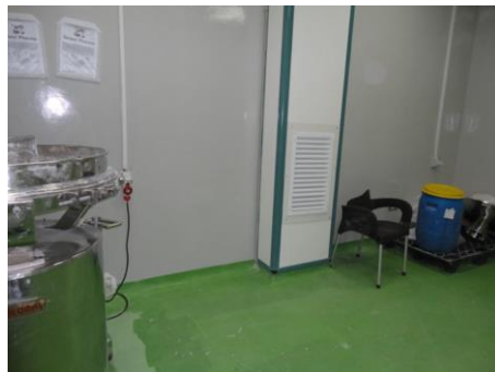
شكل (م-١٨) . فتحات سحب الهواء المستحدثة داخل غرف الإنتاج .
