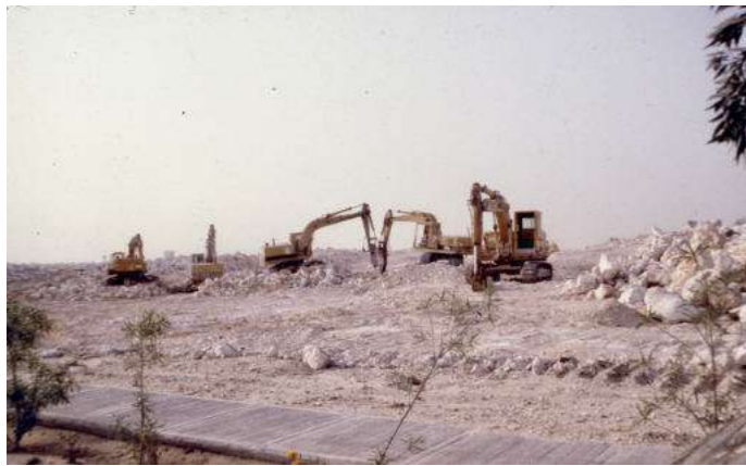
نرى في الصورة العلوية معدات تعمل في أرض لتسويتها للسكني، وهذا منظر مألوف أيضاً في كل مكان.
