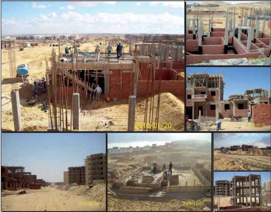
شكل (٢-٤) صور توضح عدم توافر المرافق وكذلك تفرغ الشباب للإشراف علي المقاول (بواسطة الباحث، ٢٠١٠م)
