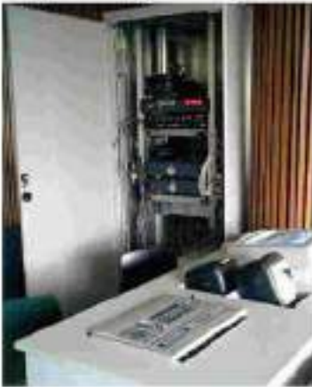
صورة رقم (4/6) وحدة التحكم Control Unit في درجة الإضاءة في الفراغ لتعليمي و الصوتيات و المحاضرات التفاعلية وغيرها ، (المصدر: Dieter W. Fellner, Armin Hopp: "VR-LAB - A Distributed Multi-User Environment for Educational Purposes and Presentations", Technical Report TUBS-CG-1999-03, ( http://graphics.tu-bs.de ), (Accessed 9/3/2006)
