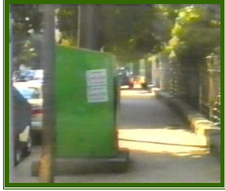
شكل رقم (60) يوضح إشغال الرصيف بصناديق الكهرباء. المصدر الباحثة.
