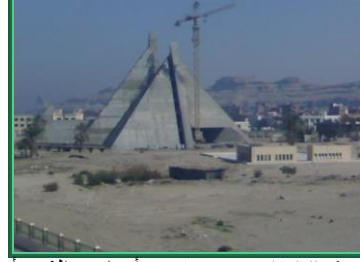
شكل رقم (144) يوضح متحف أخناتون الذي يأخذ الشكل الهرمي كعلامة مميزة على المسطاح.
