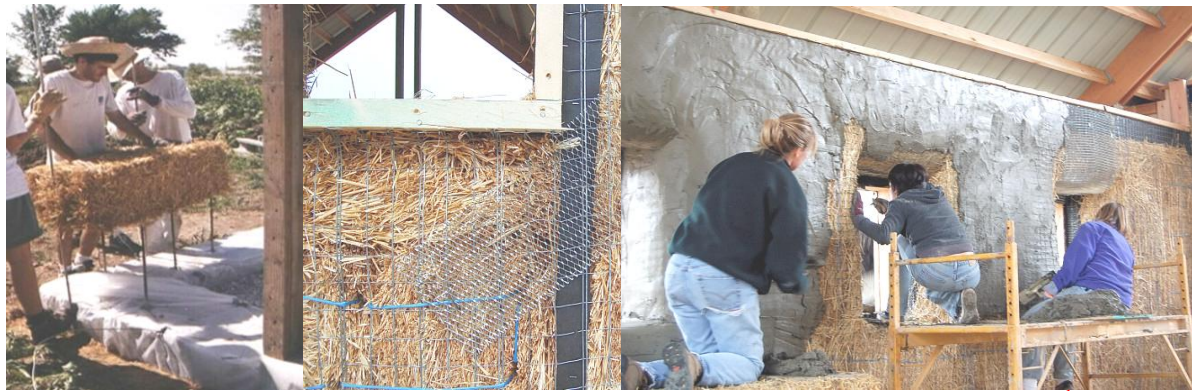
شكل (38) 1 يوضح تثبيت حوائط بالات القش بالأسياخ الحديدية ، ثم تغطية حائط القش بسلك بقلادة ، لعمل لباسة لة .
