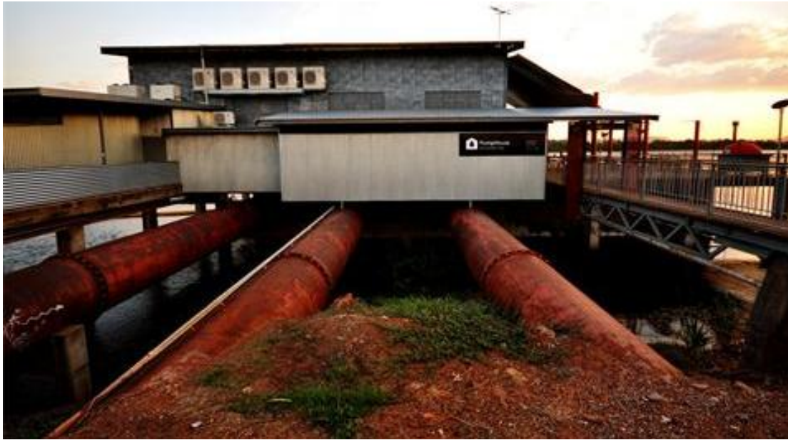
الشكل ٣-٥٦ محطة ضخ مياه غرب أستراليا
