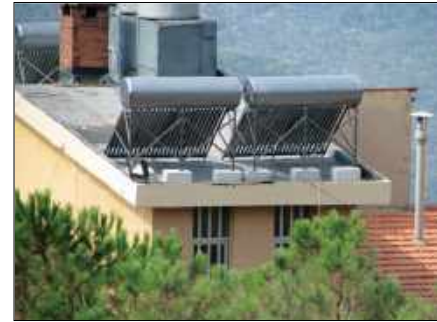
Fig(224): Prefabricated solar collectors installed in Beirut, 2012 ناجي طنوس: البيئة في لبنان: الواقع والاتجاهات- الفصل التاسع: أزمة الطاقة ٢٠١٠
