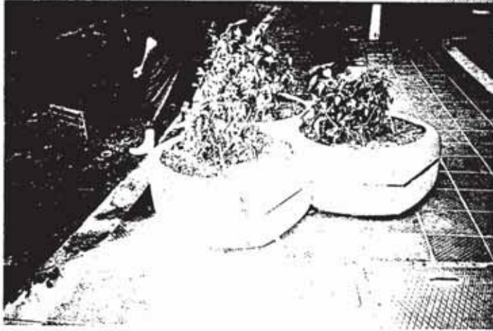
(شكل ٢-١٤٤) نتيجة لتنفيذ ميل الأرضيات بشكل خاطئ يضطر الناس إلى تحريك المياه الراكدة إلى غرف التفتيش مما يتسبب انسداد غرف التفتيش نتيجة لسقوط أجسام صلبة ومخلفات المحلات التجارية
