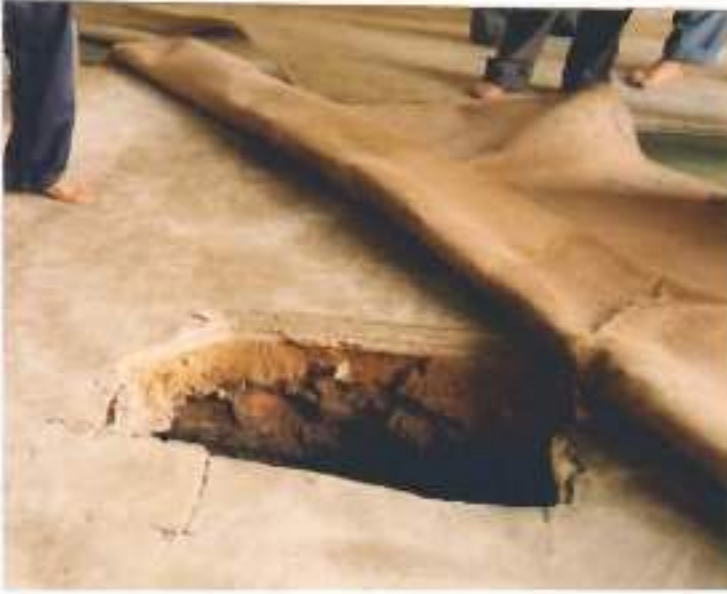
شكل رقم (١٤٠) يوضح انهيار أرضية إيوان القبلة بمسجد الصالح طلائع (١) .
