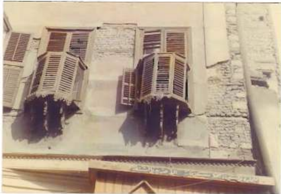
شكل رقم (١٥١) يوضح طبقة البياض التى أزيلت وتحتاج إلى ترميم لبيت زرع النوى .
