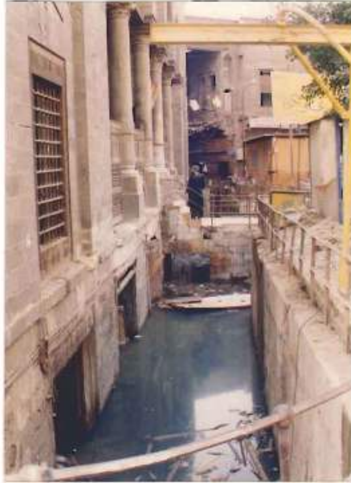
شكل رقم (٨٥) يوضح تأثير مياه الرش على جدران مسجد الصالح طلائع .
