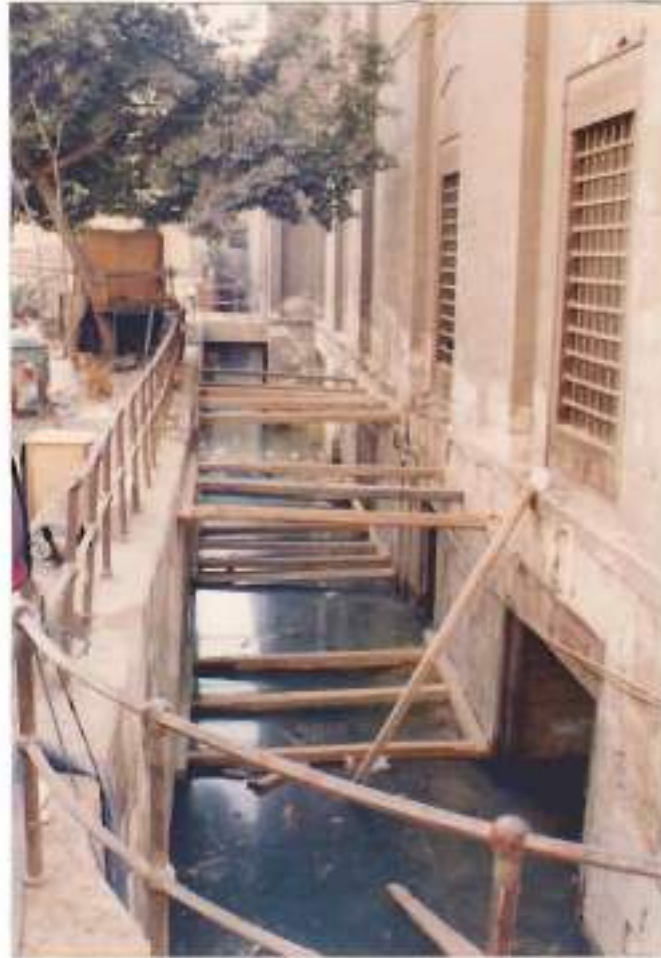
شكل رقم (١٣٩) يوضح ارتفاع منسوب المياه التحت سطحية بمسجد الصالح طلائع .
