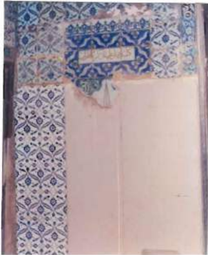
شكل رقم ( ٩٠ ) يوضح حجرة السبيل بعد تركيب لوح الجبس وانشاء لصق القيشاني .
