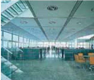
شكل رقم (٢-٤٧) يوضح وحدات الإضاءة المستخدمة بمبنى شركة " جوتز " (١) .
