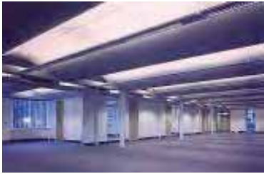
شكل رقم ( ٢٨ - ٤ ) لقطة داخلية بالمبنى يوضح نظام الإضاءة الصناعية المتكامل على الكفاءة و شكل وحدات الأضاءة المستخدمة فيه .
