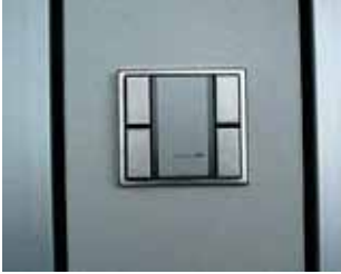
شكل رقم ( ٤ - ١٥ ) يوضح وحدات تحكم المستخدمين بمبنى بوابة المدينة
