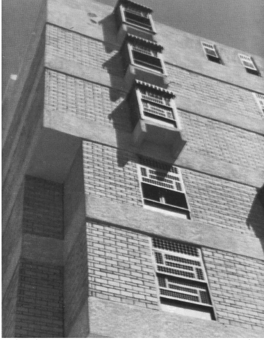
شكل (10) يوضح استخدام احد نماذج المعالجات الخاصة لفتحات الشبائيك تحقق الخصوصية بجانب التهوية والإضاءة الطبيعية.
