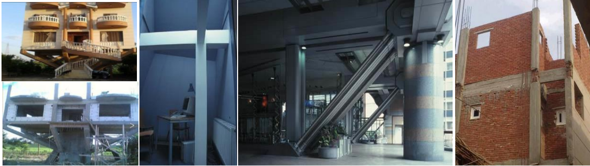
قصور في أداء وتنفيذ قطاع العمود الإنشائي، إشكالية متانة المستخدمين مبنى Alban Gate 125 ، لندن النظام الإنشائي الغير ملائم للوظيفة يعيق حركة إعاقة في أداء الوظيفة غياب الحس الجمالي وسيطرة الفراغ الداخلي التكلفة والتعبات
