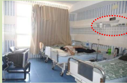
شكل (٧-٨٠) غرفة المريض الفردية، والتي تم فرشها واستغلالها ل ٣ مرضي عند الحاجة لا يتوفر بها إلا وحدة bed head unit واحدة فقط وليس ل ٣ أسرة.
