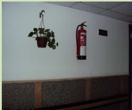
شكل (٧-٣٩) توضح استخدام الطفايات اليدوية بممرات وحدة الإقامة.
