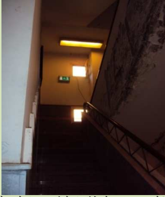
شكل (٧-٤٧) لقطة داخلية من داخل سلم الهروب، ويتضح كما هو بالصورة عدم الاهتمام بصيانة التشطيب داخله بعد وقوع البياض.
