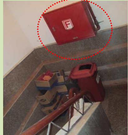
شكل (٧-٨٧) صندوق خرطوم الحريق، ويتواجد داخل فراغ سلم الهروب، ولا يوجد أي علامات إرشادية لها غير ما هو مكتوب عليها (F).
