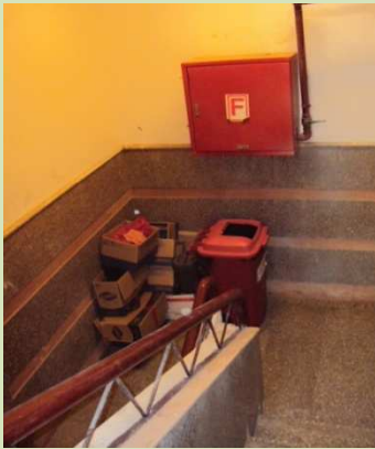
شكل (٧-٤٨) داخل سلم الهروب مستغل غرفة للنظافة وبه بعض أدوات التنظيف. بالإضافة لتواجد خرطوم مياه يدوي لإطفاء الحريق.
