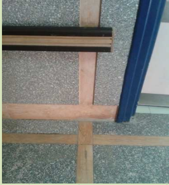
شكل (٧-٢١) يوضح التنشيطات المستخدمة بالممرات حيث يوجد فواصل غير ملحومة جيدا، واتصال الحوائط بالأرضيات غير دائرية.
