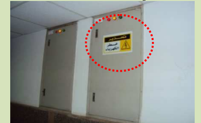
شكل (٧-٨٢) استخدام اللافتات التحذيرية علي المناطق الخطر.
