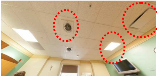
شكل (٥٣-٦) أنواع الإضاءة بسقف غرفة المريض.
