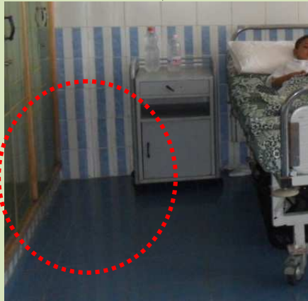
شكل (٧-٢٠) يوضح التشطيبات المستخدمة بغرف المرضى، حيث يوجد فواصل غير ملحومة جيدا، واتصال الحوائط بالأرضيات غير دائرية.
