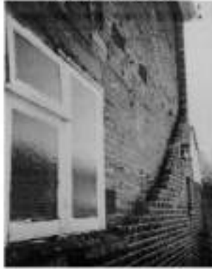
شكل (٥-٤) فشل الجدار الخارجي في مقاومة الحواصيف ١٩٩٠م بسبب تآكل الوابطة ١
