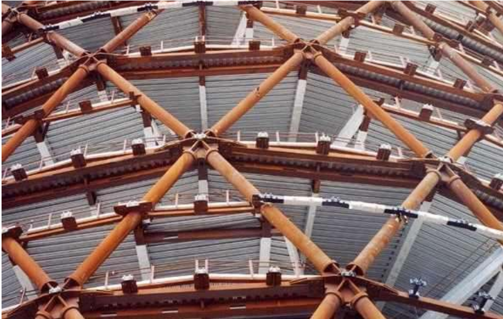
شكل (٤٢/٣) استخدم لتنفيذ المبنى ٣ أوناش ضخمة (Tower Cranes) لتركيب تلك الوحدات المكونة للشكل الحلزوني الخارجي للبرج
