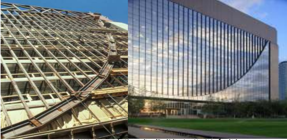
شكل رقم (٨٥/١) مبنى البنك الفيدرالي بمينابولس - عام ١٩٧٣ م استخدام انظمة الكابلات لتعليق البلاطات- بدون اعمدة داخلية.
