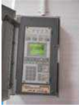
شكل(٣-٥٣): لوحة كمنترول المتصلة بوحداث أجهزة الإطفاء والحريق لكل فراغ إداري
