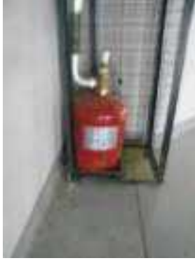
شكل (٣-١٠٤): إسطوانة غاز FM200 المستخدم لإطفاء غرف الكنترول
