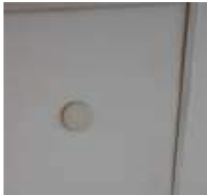
شكل(٣-٥٨): Sprinklers المستخدم بالمكاتب
