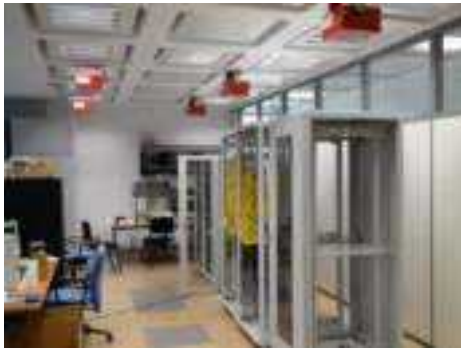
شكل(٣-٥٥): نظام الإطفاء بالأيروسول داخل غرفة IT Room ويتم تثبيته خارج السقف
