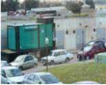
شكل (٣-٥٠): غرف مولدات الطوارئ الثابتة والمتحركة الخاصة بالمبنى
