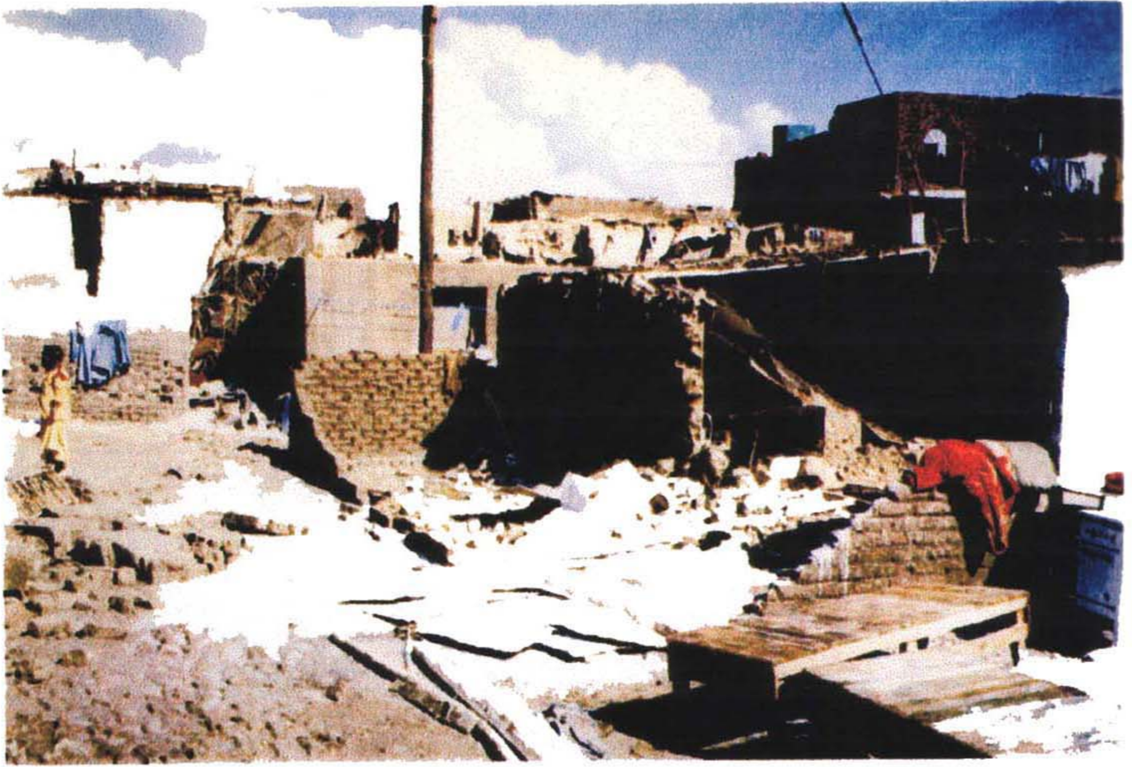
المنزل المتهدمة بمنطقة الملاحه
