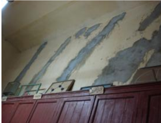
الشكل (٢-٢٧) معالجة شروخ أحد الحوائط بمدرسة طلعت حرب الفنية بالحوائط، (تصوير الباحثة ٢٠٠٥)
