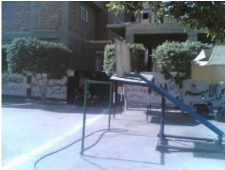
شكل ( ٦ - ٩ ) يوضح عدم انتظام شكل الكتل بالموقع العام بمدرسة مجمع عبد الحلیم مأمون للتعليم الاساسي - المصدر : الهيئة العامة للأبنية التعليمية
