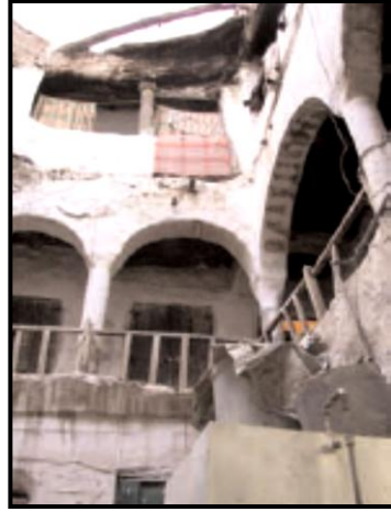
شكل ٣-٥٤: تدهور إحدى المباني بمدينة صنعاء القديمة
