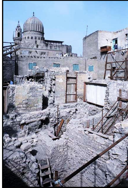
شكل ٣-٧٩: تدهور المباني السكنية بمنطقة درب الأحمر
