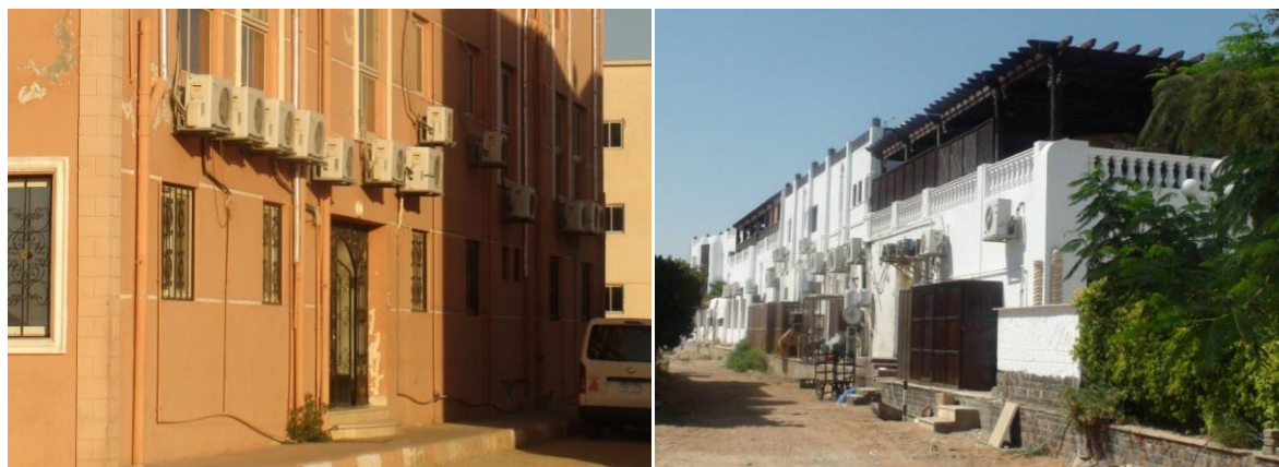
Figure 2.35 : Des façades faussées en raison de l'utilisation intense des unités d'air conditionné, un bâtiment résidentiel à gauche et l'hôtel d'Oriental Rivoli à droite, Charm El-Cheikh, Sinäi.
