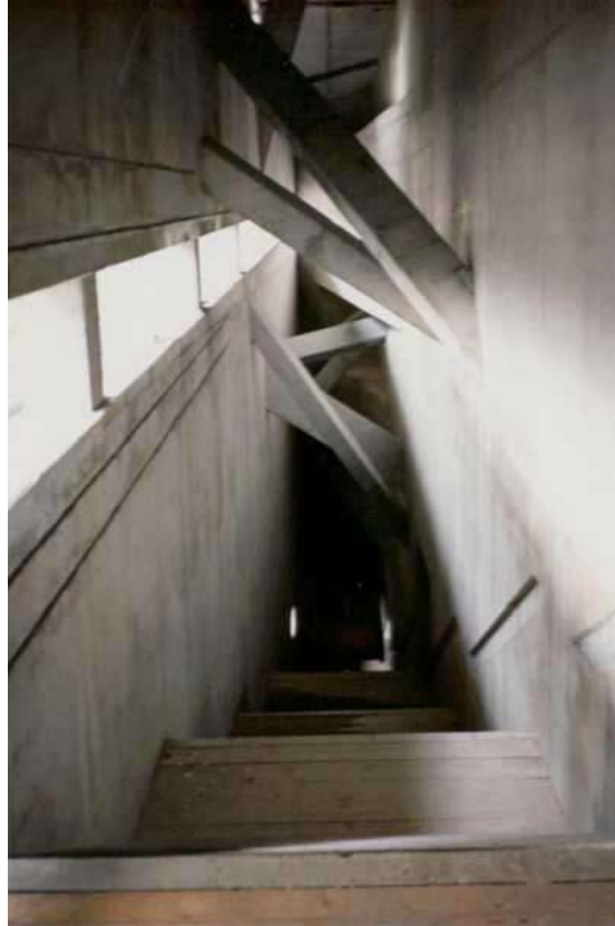
شكل رقم ٣-١٣ يوضح الكمرات التي تربط الحوائط ببعضها البعض لمقاومة عوامل الضغط والشد في المبنى (المصدر: Emma E. Scarmack, 2004)
