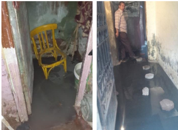
شكل (٤-٣) تهاك شبكة الصرف الصحي بالعزبة المصدر: الباحثة (٢٠١٤)
