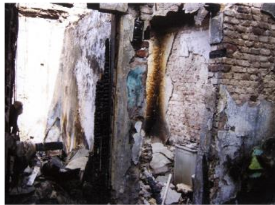
شكل (٤-٧) إحدى المباني المحترقة بعزبة أبو حشيش المصدر: صندوق تطوير المناطق العشوائية (٢٠١٤)
