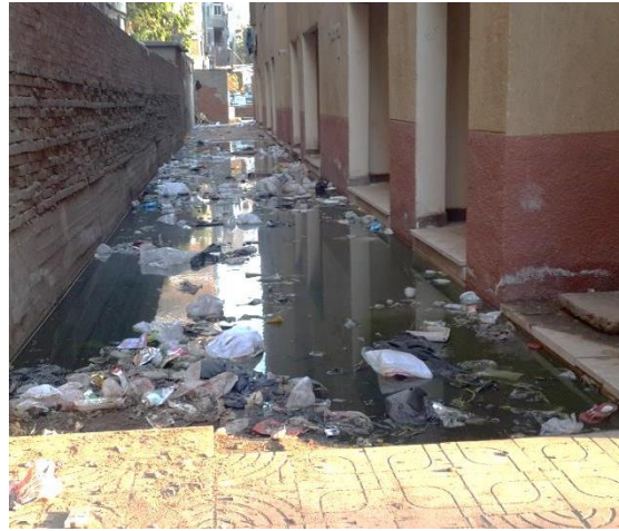
شكل (٤-١٩) سوء حالة شبكة الصرف الصحي بعشش السكة الحديد المصدر: الباحثة ٢٠١٤
