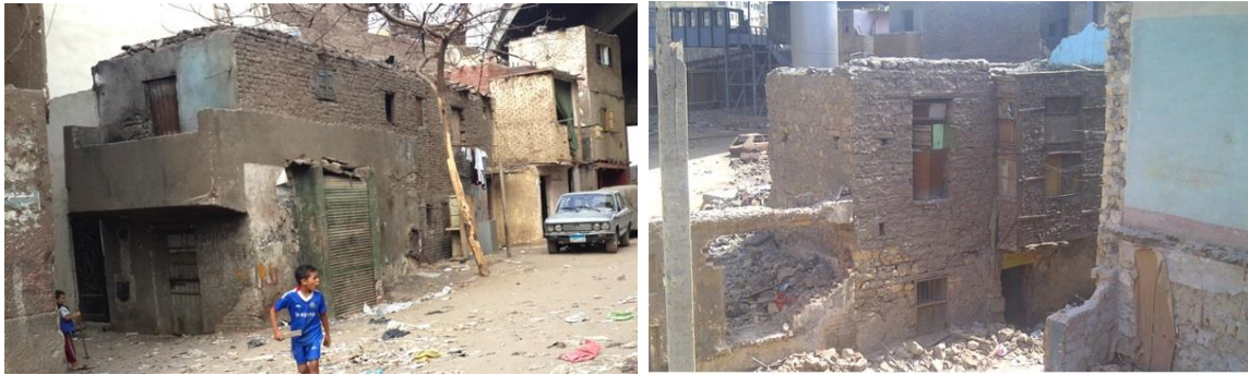
شكل (٤-٢) حالة المباني بمنطقة عزبة أبو حشيش المصدر: الباحثة (٢٠١٤)
