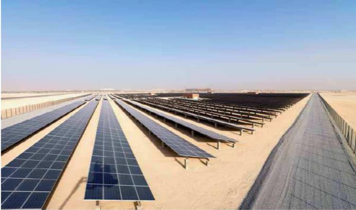
شكل (٤-١٠): محطة الطاقة الشمسية بطاقة ١٠ ميغا وات
