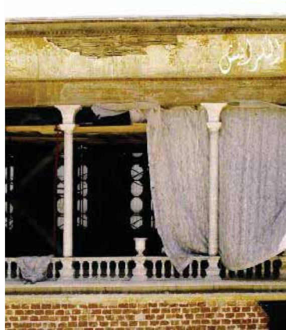
(شكل ٣ - ١٣): تلف الكرانيش الخشبية من الرطوبة و الفطريات المصدر: مشروع ترميم قصر محمد علي بشبرا - القاهرة التاريخية
