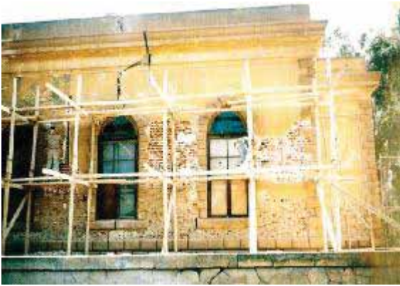
( شكل ٣ - ٣ ): أعمال الصلب المؤقت احد طرق التدعيم الفوقي. المصدر: مشروع ترميم قصر محمد علي بشبرا - القاهرة التاريخية
