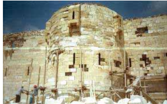
(شكل ٢ - ٦٢): احد أبراج القلعة و قد تعرضت نهائيه للانهيار. المصدر: وزارة الثقافة - المجلس الأعلى للآثار - آثار الإسكندرية (قلعة قايتباي)
