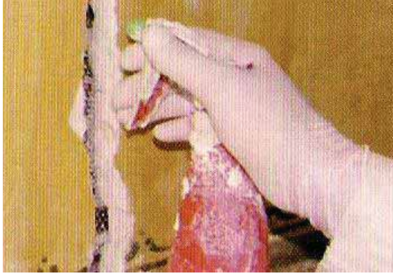
(شكل ٣ - ١٢): حقن و ملئ الشروخ بمواد معقمة و مقوية . المصدر: مشروع ترميم قصر محمد علي بشبرا - القاهرة التاريخية
