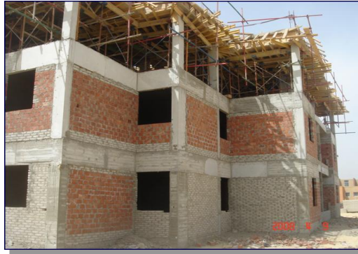
شكل(18) فترات ممتدة في انتظار شك الخرسانة وفك الشدة الخشبية للسقف (من 3-4 أسابيع)
