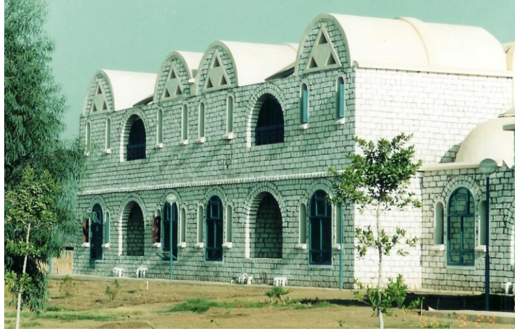
(شكل 2) مبنى من الحوائط الحاملة بالحجر المنشور دون بياض سوى بالأسقف. تصوير المؤلف : وكالة الطاقة الذرية، إنشاص، مصر
