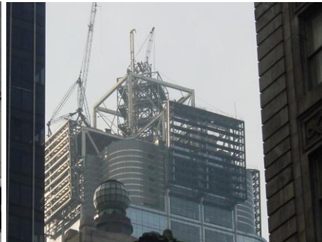
تجهيزات المبنى العلوية
