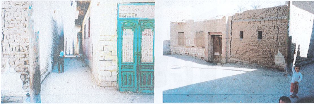
شكل (١-٢) نماذج لمباني طينية منخفضة ذات حالة رديئة
