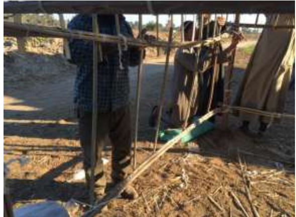
شكل 5-31 التقفييل النهائي للنظام الانشائي: يتم وضع الدعائم الرأسية في الواجهة الشمالية لمعالجة انبعاج الكمره الفرعية. المصدر: الباحث.
