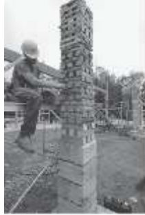
شكل 2- 9 استخدام قطع الاخشاب في عمل أعمدة ببنية لرفع الجمالونات الخشبية المصدر: Magwood, Chris, Building Better Buildings: A Comparative Guide to Sustainable Construction (Gabriola Island, Canada: New Society Publishers, 2014) (p. 64).
