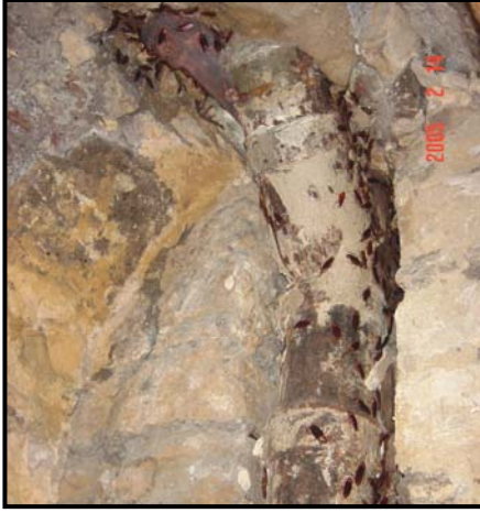
Figure 4-77 Cast iron pipes of the old sewage system (February 2005) المواسير الزهر لشبكة الصرف الصحي المتآكلة (فبراير ٢٠٠٥)
