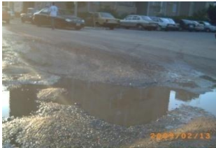
شكل (8-70): سوء حالة نهج الطرق على طريق العيادة. المصدر: الباحثة.
