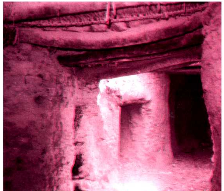
شكل (١) انبعاج الكمرات الخشبية نتيجة الأحمال الزائدة (الواحات الخارجة)
