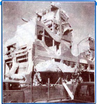
مبنى منهار نتيجة الزلزال بالمكسيك وهو مبنى بالطوب المسلح
