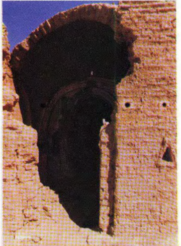
استخدام الطوب الطغلى في بناء جميع العناصر المعمارية في البجوات والتي استوحى منها المعمارى حسن فتحى أعماله بقرية باريز الجديدة .
