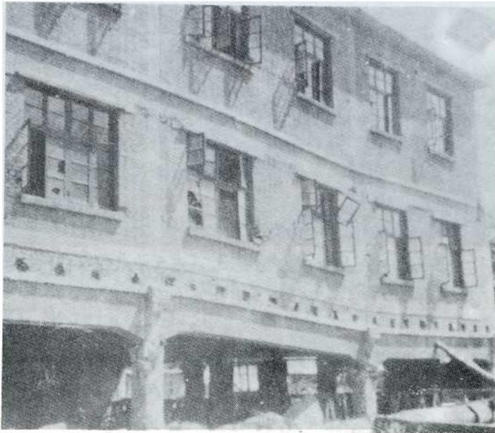
المنشآت الهيكلية الخرسانية أكثر عرضة للانهار - تعرض هذا المنشأ للدمار في زلزال تيجشان ١٩٧٦ م .
