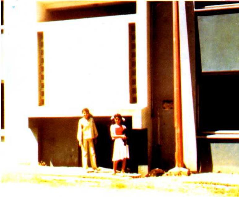
▲ مبنى سكني في مدينة الأصنام : نلاحظ حدوث قص في مستوى أسفل أرضية الدور الأرضي ، والتي كانت مرتفعة عن مستوى الأرض بحوالي ١ر٠٠ م ، وذلك بسبب عدم تزييط الأعمدة بميد قوية مقاطعة في مستوى القواعد .
