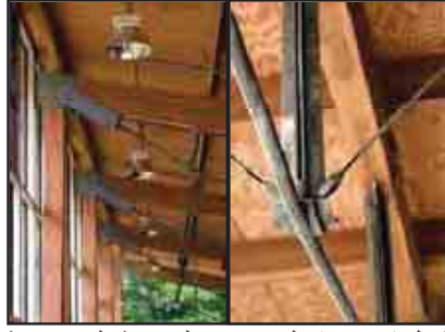
شكل (٣- ٦٠) الوصلات المعدنية المستخدمة في تدعيم السقف الخشبي والتي تعطي المبني إمكانية الفك و إعادة الاستخدام.
