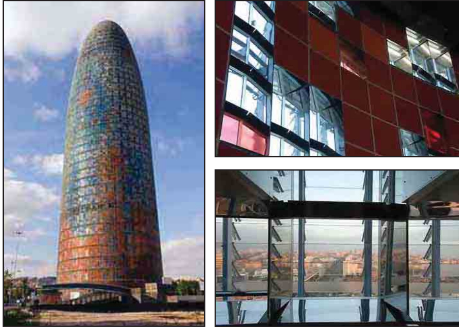
شكل (٢-٢٤) استخدام الحوائط الستائرية الزجاجية في تكوين الأعلفة الخارجية برج Torre Agbar Barcelona - برشلونة أسبانيا.
