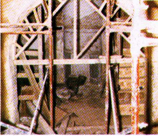
● منظر عام للمسجد أثناء الترميم ويظهر اضرار واحد العقود
