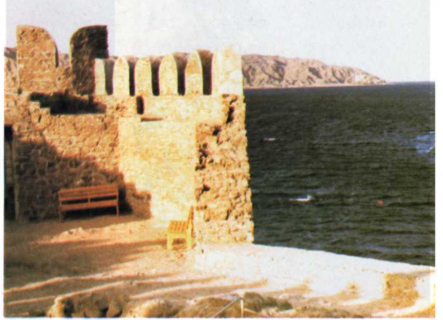
جانب من السور الشمالى الغربى للتحصين الشمالى بعد الترميم . ويظهر جزء من الباب الرئيسى .
