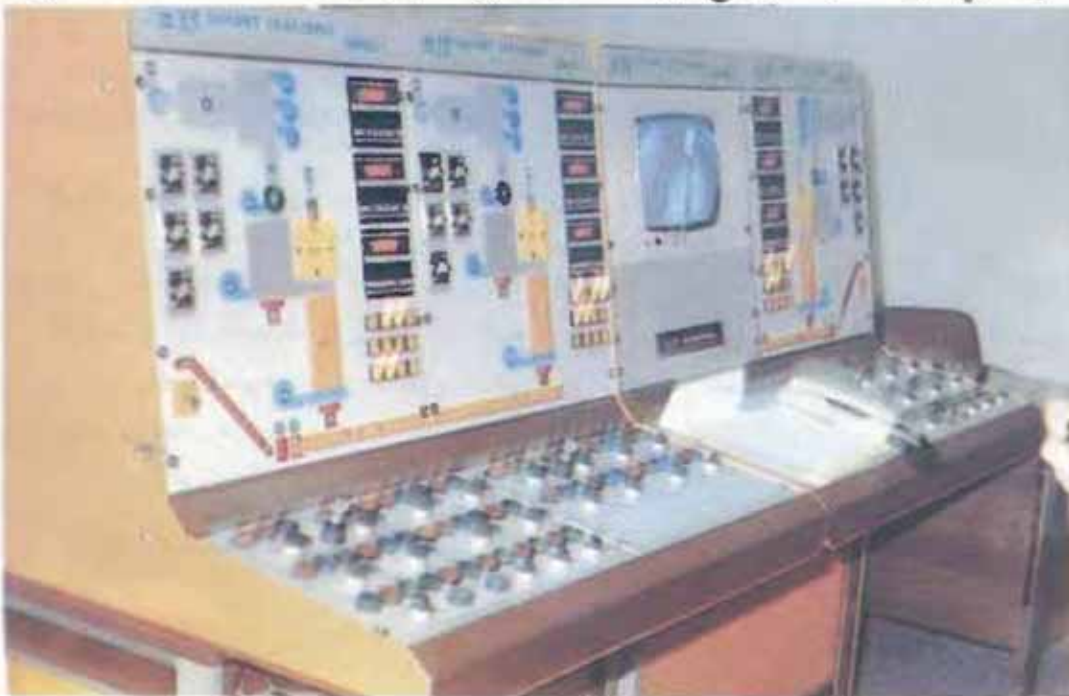
غرفة تشغيل تلفزيونية محارق النفايات بمكة المكرمة .
